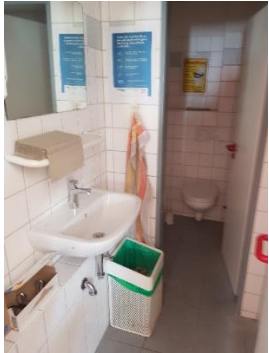
Vorher Toilette oben
